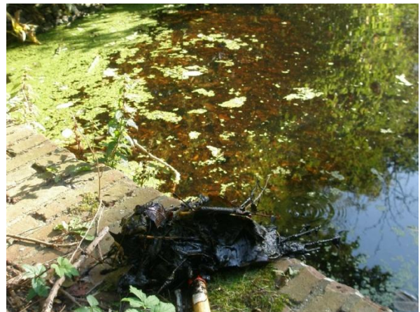
Dicht geslibte duikers waarbij op de foto ook is te zien dat er nauwelijks water staat.
